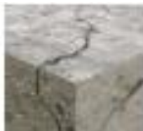
Бетон с трещинами
