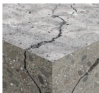
Бетон с трещинами
